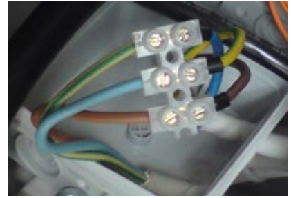
Abb. 7: Hier wurden N- und PE vertauscht
