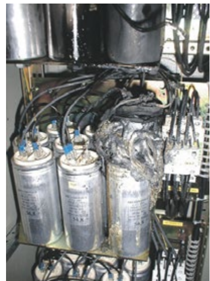
Abb.: Zerstörte Kondensatoren durch Oberschwingungen
